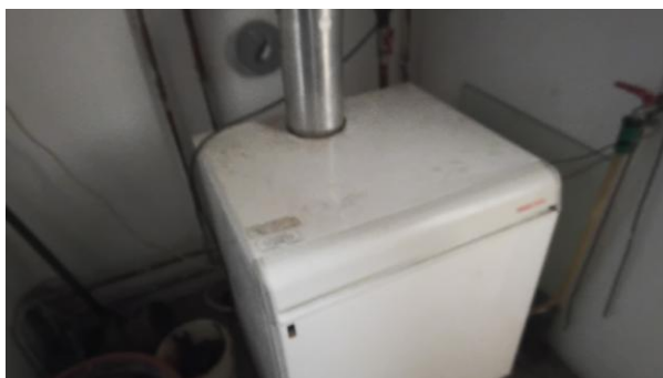
Obrázek 10: Zdroj vytápění objektu – Obecní úřad
